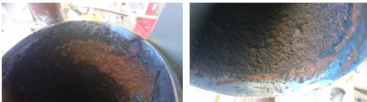
Рисунок 1 – Внутренние поверхности изношенных труб
